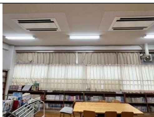
図書室 設置後
